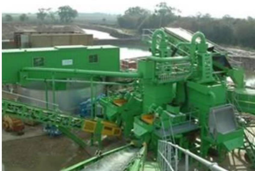
Εικόνα 5. Κεντρικό συγκρότημα επεξεργασίας άμμου: Αφαίρεση ανεπιθύμητων προσμίξεων, έλεγχος ποσοστού παιπάλης στα επιθυμητά όρια, διαβάθμιση άμμου, ελαχιστοποίηση απώλειας λεπτού υλικού, ελεγχόμενη υγρασία <math>< 12\%</math>, ανεξάρτητα από τη σύνθεση του τροφοδοτούμενου υλικού.
